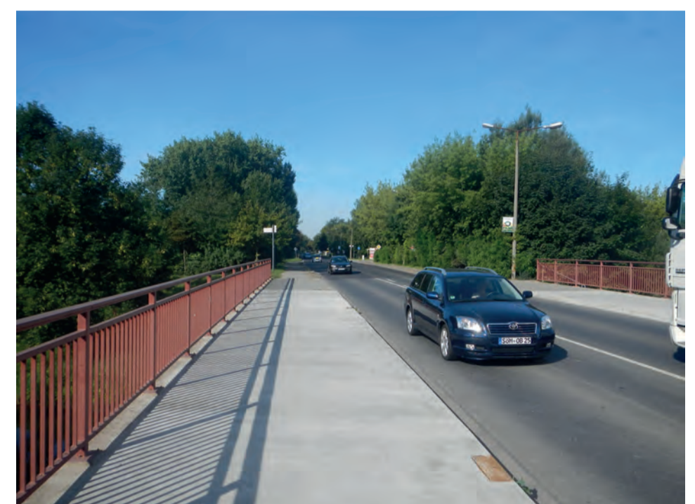
Bild 8: Die größte Gefahr für den einwandernden Fischotter ist der Straßenverkehr, weil Otter einen trockenen Uferstreifen unter einer Brücke benötigen, um diese zu passieren. Sind die sogenannten "Bermen" nicht vorhanden, queren Otter offenbar öfter die Straße statt unter der Brücke hindurch zu schwimmen und können dabei zu Opfern des Straßenverkehrs werden (siehe auch Bild 3 und Bild 4).
