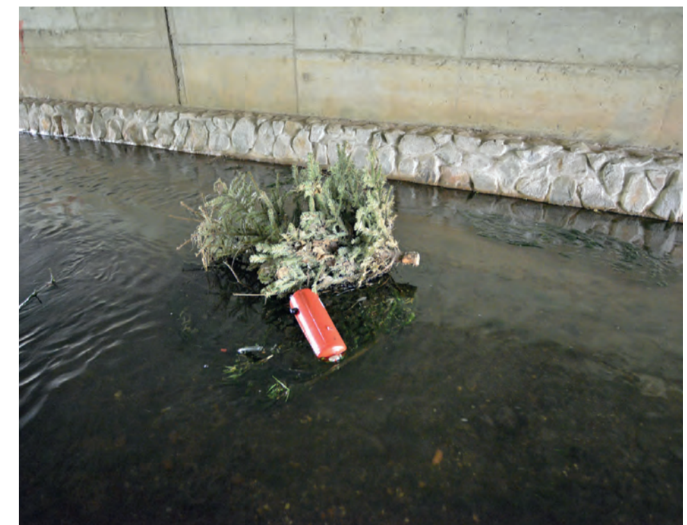
Bild 14: Es weihnachtet sehr... auch solche "Totholz" findet sich mitunter an Brücken und in den Gewässern wieder. Diese Ablagerung ist augenscheinlich nicht durch die Berme verursacht worden.
