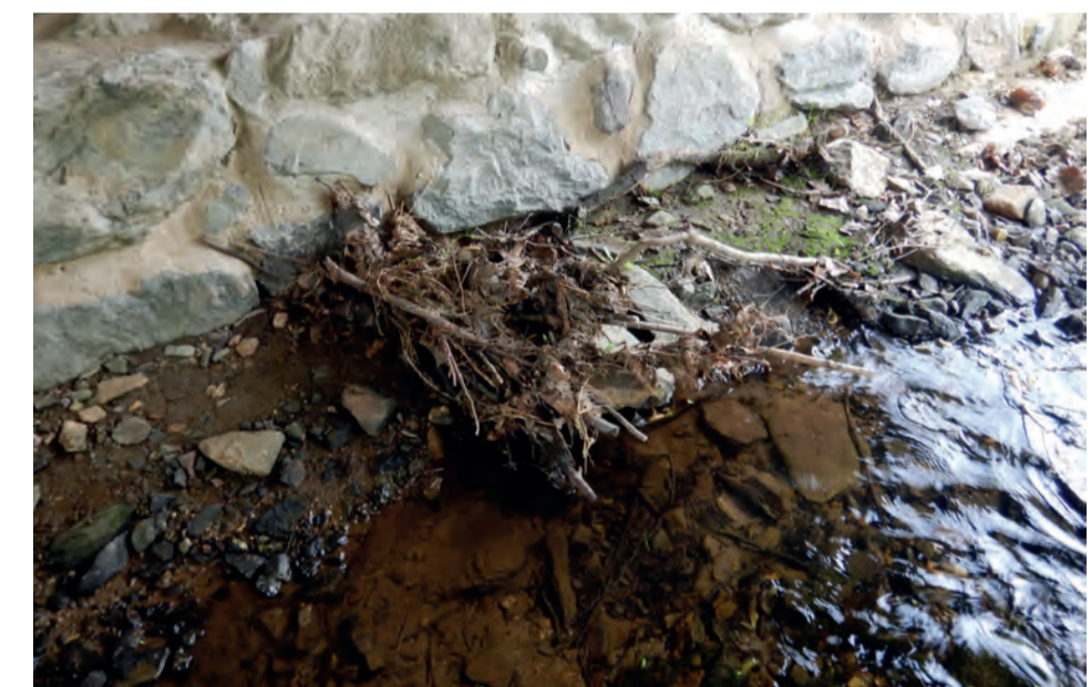
Bild 17: Getriebel an der Berme unter der Brücke über den Pölschbach (Pb1) zwischen Untergeissendorf und Berga. Kleinere Ablagerungen sind normal und werden bei stärkerer Strömung wieder ausgetragen.
